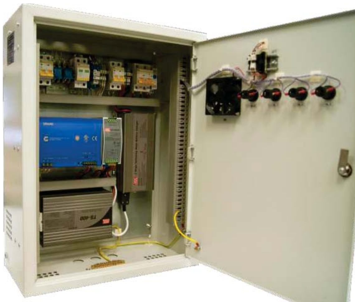
Рисунок 8. Внутренний монтаж АБП-ОО-400-220/24
